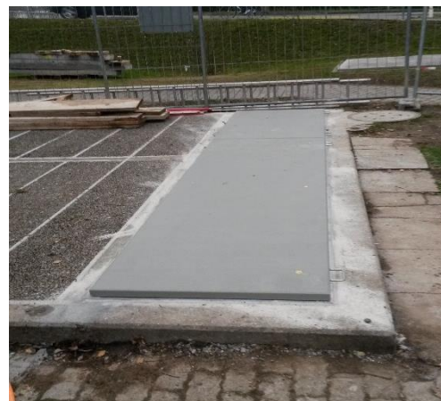
Station de pompage de Baleinen à Nidau : couvercle de regard du type S1a en 2 parties, praticable à pied, 4550 x 800 mm, position fermée
