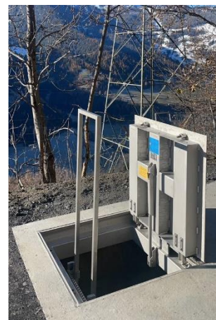
Le Rocher: S21 Schachtabdeckung 1000 x 1000 mm, ausziehbare Leiterverlängerung
