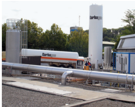
Links die obere Hälfte des Ozonreaktors, der im Pumpenschacht steht. In der Mitte die Sauerstoffversorgung. Rechts der Container mit dem Ozongenerator und der Steuerung sowie der Überwachung der Gesamtanlage.
