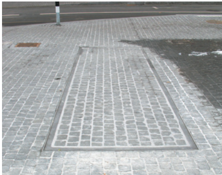
Limmatquai Zürich: die Schachtabdeckung ist vollständig in die Strassenpflasterung integriert.
