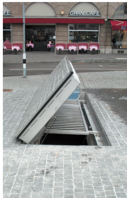
Auf Knopfdruck wird die tonnenschwere Abdeckung hydraulisch angehoben.
