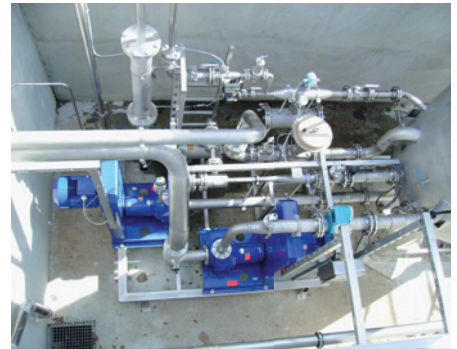
Pumpenrack mit der Ozon-Einspeisung (rechts) in den Reaktor.
