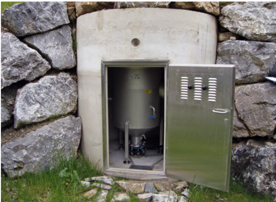
Chambre de captage moderne avec système WABE®
